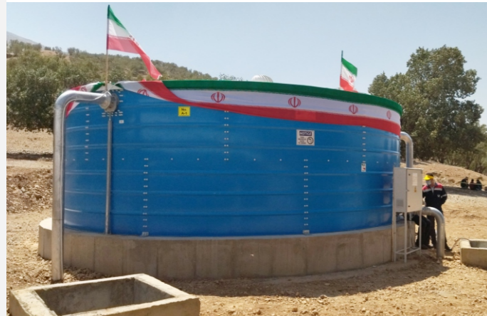
پروژه آب و فاضلاب شیراز- فتح آباد - ۱۱۶ مترمکعب Project of Water and Sewerage of Shiraz - Fath Abad - 116 m 3
