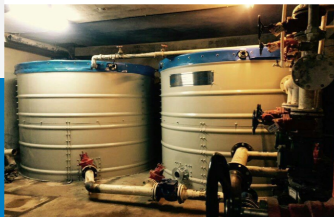
پروژه تاسیسات موتورخانه ای - برج های نگین - همت غرب - ۲۰ مترمکعب Project of Engine room facilities - Negin Towers - Tehran - 20 m 3
