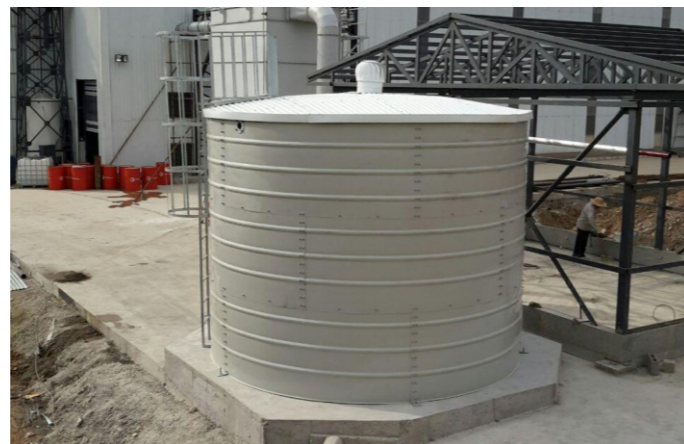
پروژه کارخانه روچین پایا - رشت - ۱۵۰ مترمکعب Project of Rojin Paya - Rasht - 150 m 3
