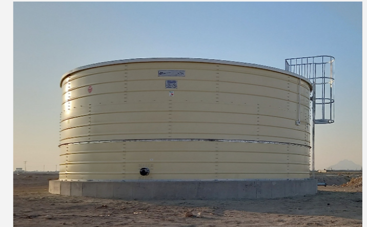
پروژه آب و فاضلاب اصفهان - هرمدان (کلودان) - ۳۰۰ مترمکعب Project of Water and Sewerage of Isfahan - hermedan - 300 m 3
