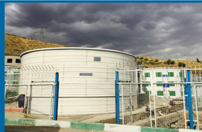
پروژه دانشگاه آزاد واحد علوم و تحقیقات - تهران - ۲۵۰ مترمکعب Project of Azad University of Science and Research - Tehran - 250 m 3
