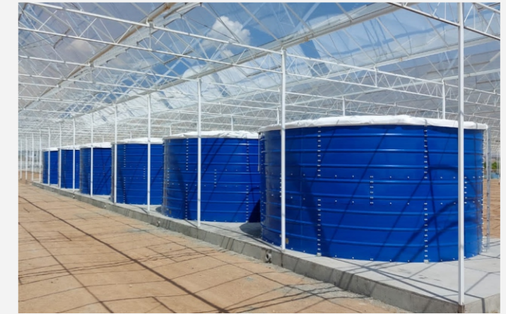
پروژه گلخانه - آبیگ - قزوین - ۱۰۰ مترمکعب Project of Greenhouse - Abyek - Qazvin - 100 m 3
