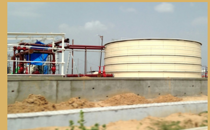
پروژه عسلویه - ۷۰۰ مترمکعب Project of Asaluyeh - 700 m 3
