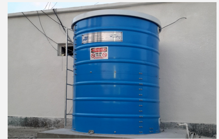
پروژه موتورخانه تله کابین - توچال - تهران - ۲۵ مترمکعب Project of Tochal Powerhouse - Tehran - 25 m 3
