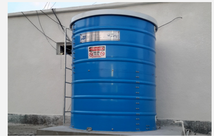
پروژه موتورخانه تله کابین - توچال - تهران - ۲۵ مترمکعب Project of Tochal Powerhouse - Tehran - 25 m 3
