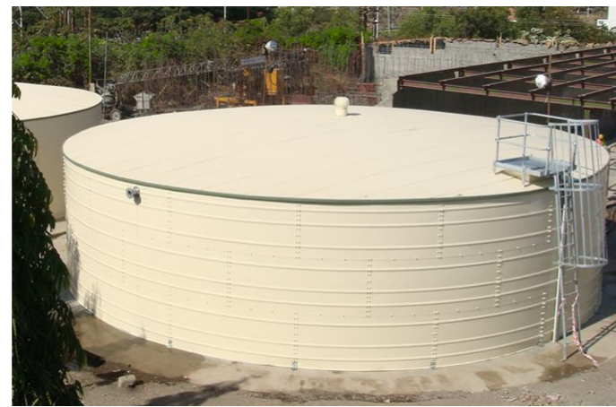
پروژه نیروگاه سیکل ترکیبی - مازندران - ۵۰۰ مترمکعب Project of Combined Cycle Power Plant - Mazandaran - 500 m 3
