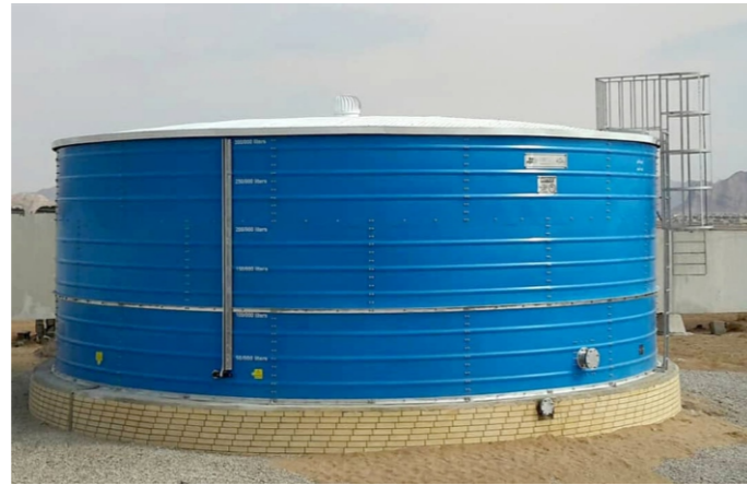
پروژه آب و فاضلاب اصفهان - شهرضا - ۳۰۰ مترمکعب Project of Water and Sewerage of Isfahan - Shahreza - 300 m 3
