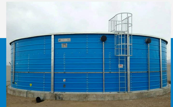
پروژه مهاباد - اردستان - اصفهان - ۵۰۰ مترمکعب Project of Mahabad - Ardestan - Isfahan - 500 m 3
