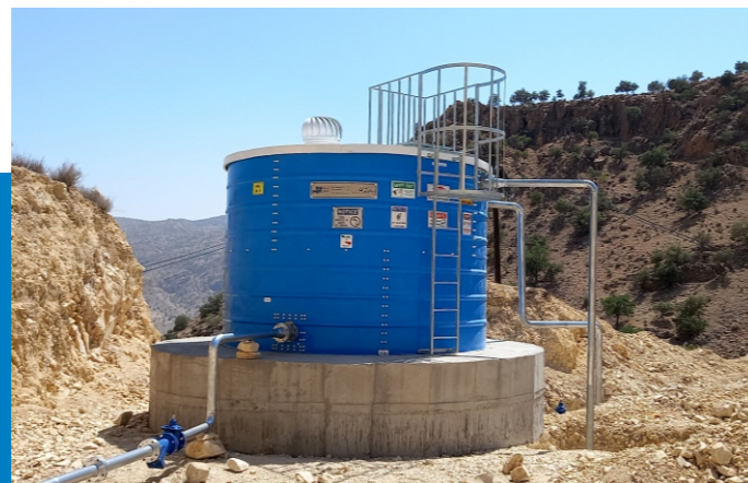
پروژه آب و فاضلاب شیراز - بگدانه - ۵۰ مترمکعب Project of Water and Sewerage of Shiraz - Bagdaneh - 50 m 3
