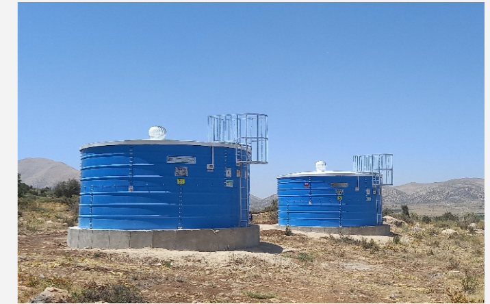
پروژه آب و فاضلاب شیراز - خان زنیان - ۵۰ مترمکعب Project of Water & Sewerage of Shiraz - Khan Zanian - 50 m 3
