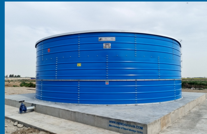
پروژه آب و فاضلاب استان گلستان - آق قلا - ۳۰۰ مترمکعب Project of Water & Sewerage of Golestan - Aqqala - 300 M 3
