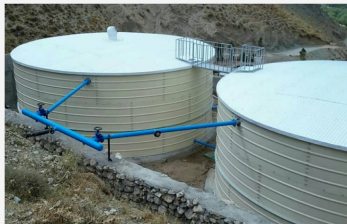
پروژه لواسان بزرگ - تهران - ۲۵۰ مترمکعب Project of Lavasan-e Bozorg - Tehran - 250 m 3
