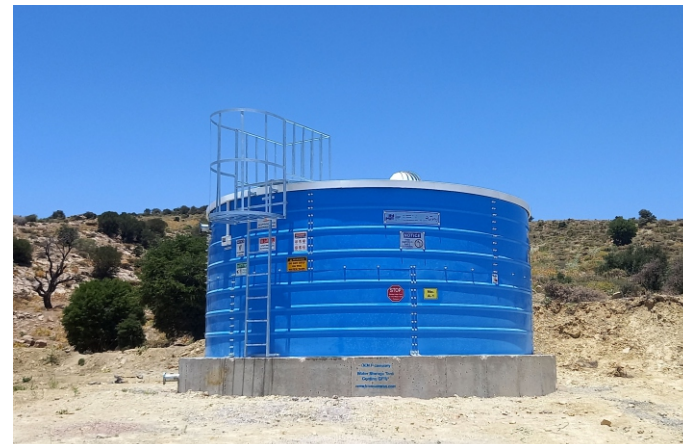
پروژه آب و فاضلاب شیراز - بیدقار - ۵۰ مترمکعب Project of Water & Sewerage of Shiraz - Bidghatar - 50 m 3
